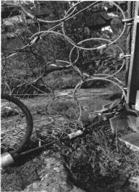
Figur 3. Korrosjon på bunnwire
