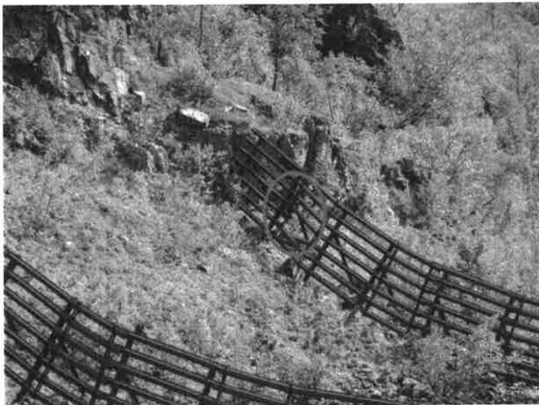
Figur 17. Detalj av skadet bjelke (Rødt)
