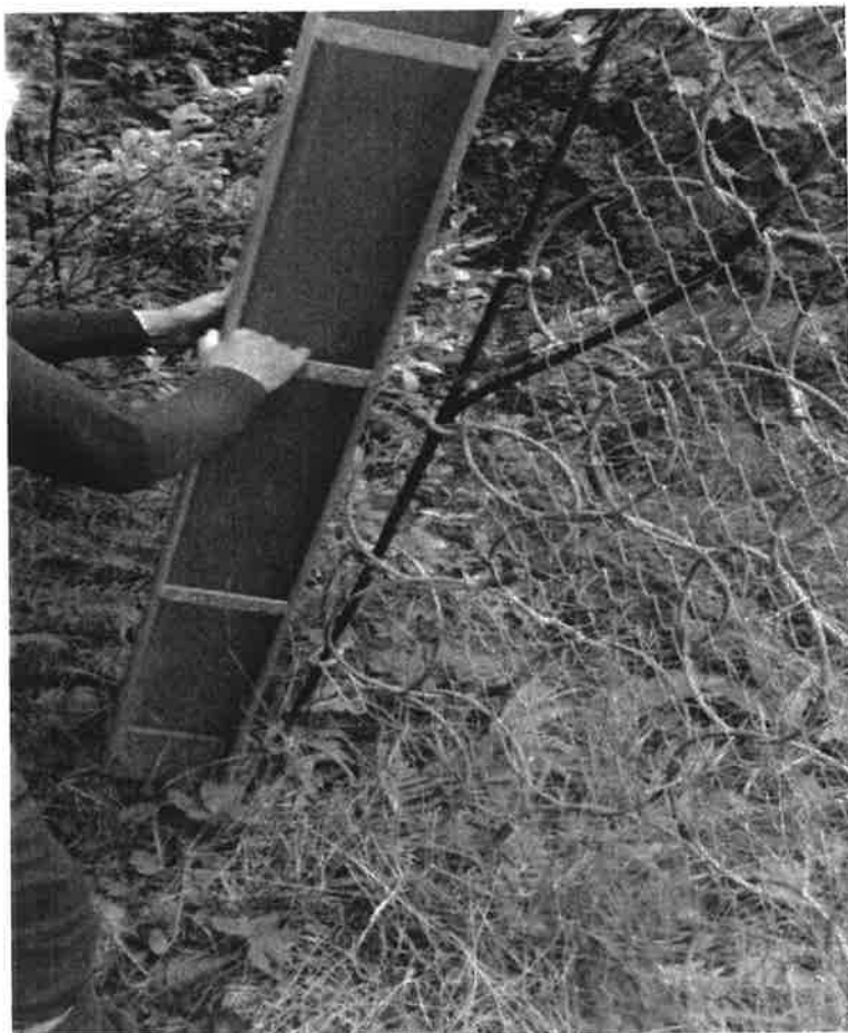
Figur 5. Korrosjon på vertikal bærewire
