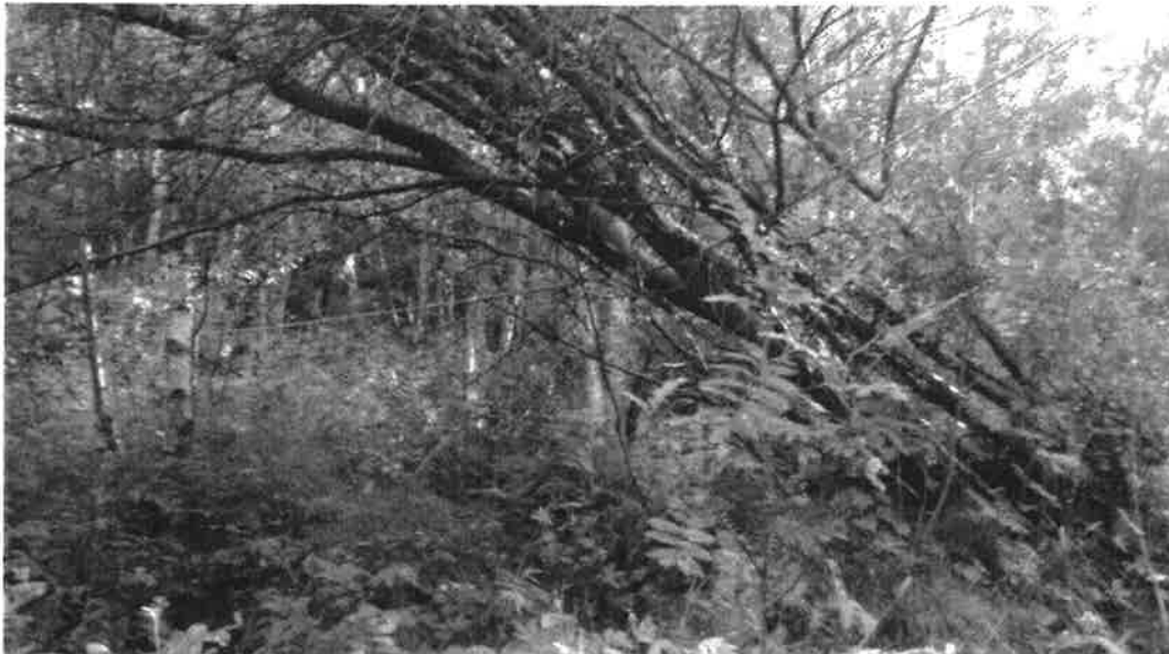
Figur 1. Trær har lagt seg opp mot strekkforankring
