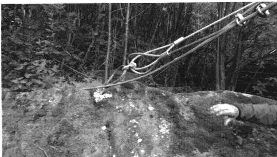
Figur 2. Eksempel på korrodert forankring
