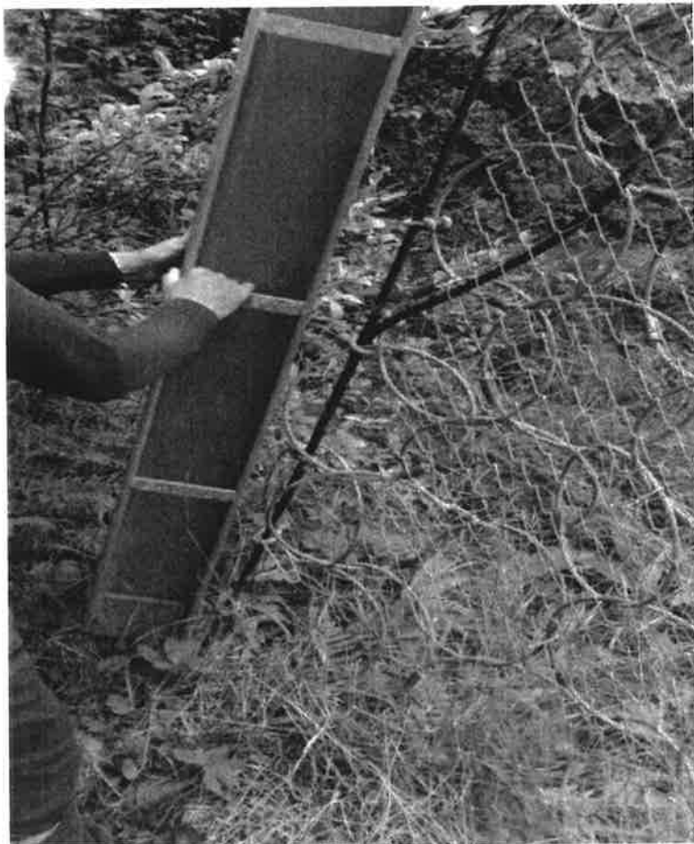
Figur 5. Korrosjon på vertikal bærewire
